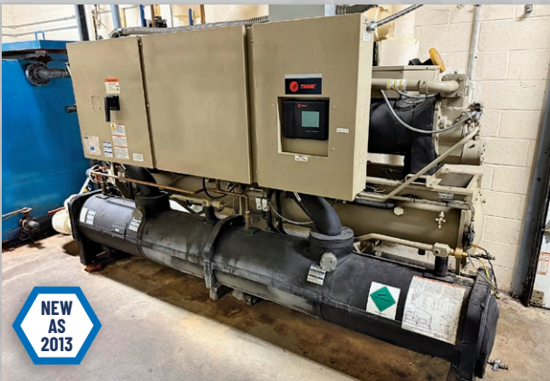
120 Ton & 80 Ton Trane Chillers
